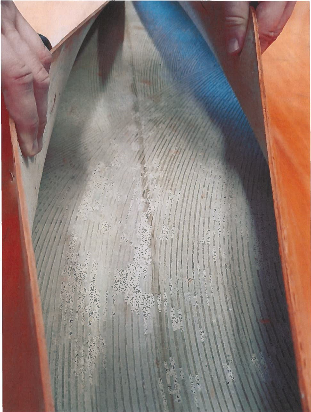
Kuva 1. Nyk. betonilattian kunto, kuntosalin puolella
