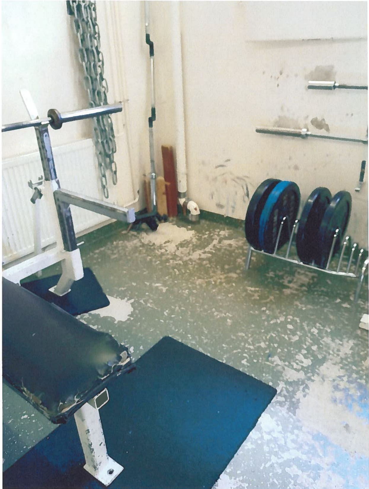
Kuva 2. Voimanosto puolen lattian kunto
