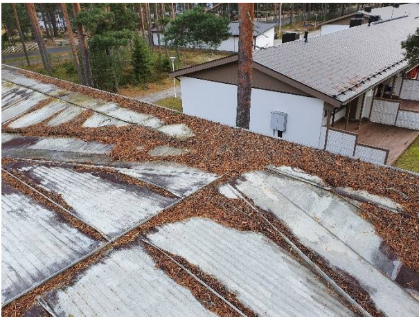
Päärakennuksen katolla runsaasti neulasia
