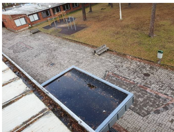
Kirjaston tuulikaapin kattokaivot tukossa
