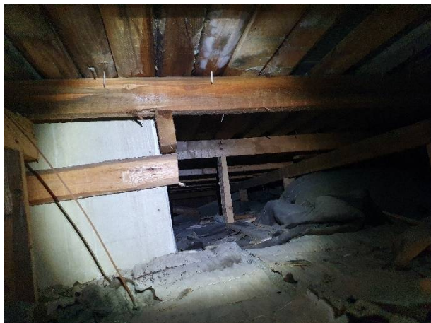
Kattoikkunoiden alanurkilla vuotoja
