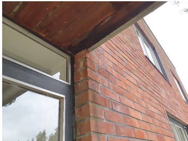
Kirjaston päädyssä olevan oven vieressä seinässä valumajälki, laudoitus kastunut
