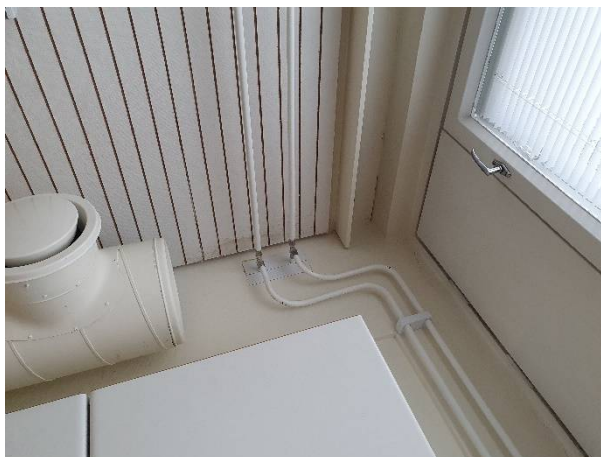
Pieni vuotojälki katossa
