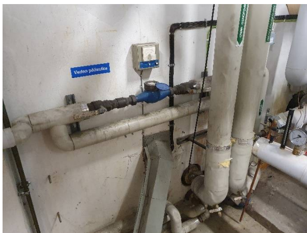
Päävesimittari teknisessä tilassa
