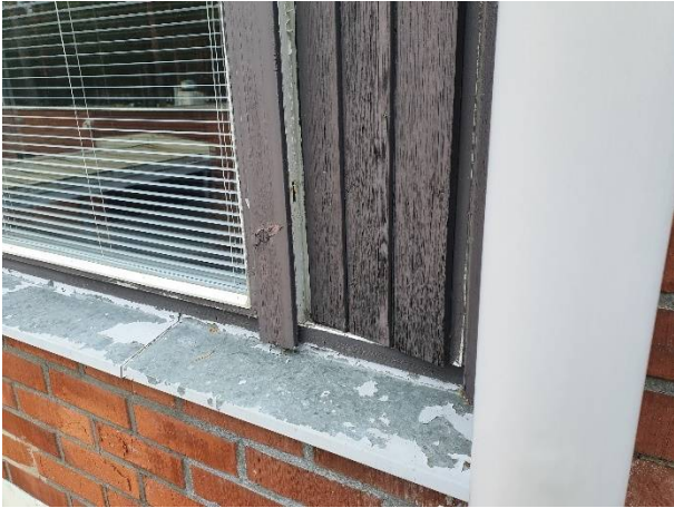
Puiset tuuletusluukut ravistuneet
