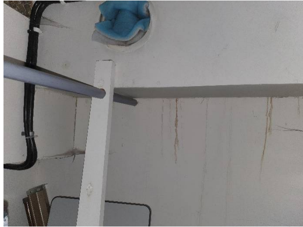
Näytelmävaatevaraston seinässä veden valumajälkiä
