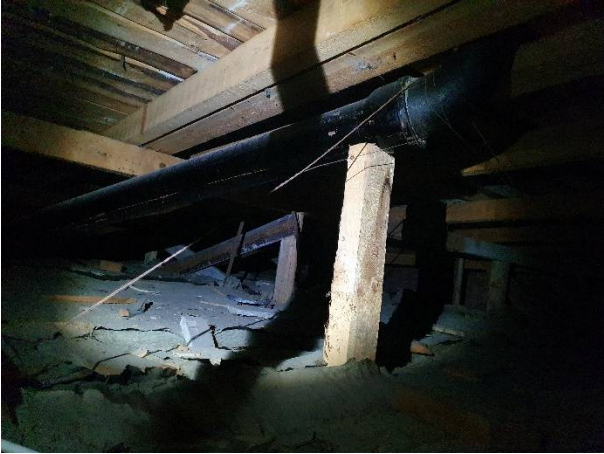
Viemärin tuuletusputket lämmöneristämättä
