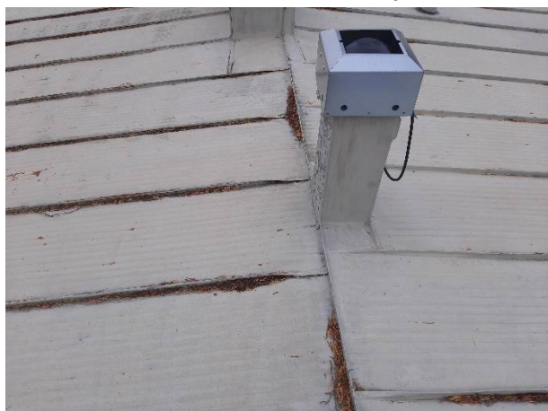
Yläpohjan tuuletus harjalla olevien puhaltimien avulla
