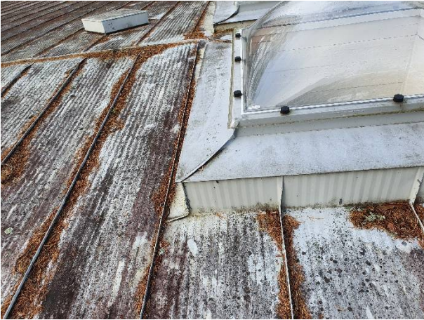
Kattokupujen alanurkillla vuotoja
