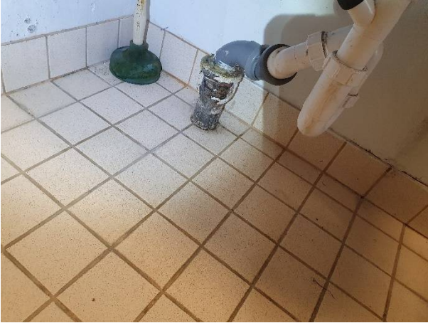
Allasviemärin liitos vuotaa kotitalousluokan yhteydessä olevassa siivousskomerossa
