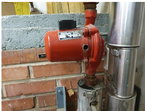
Keittiön iv-koneen lämmityksen kiertovesipumpussa vuoto
