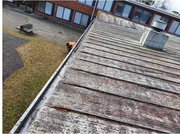
Vesikatteessa runsaasti likaa
