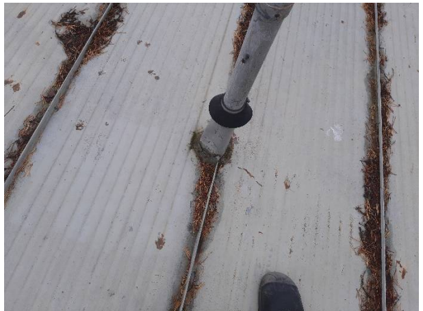
Antenniputken läpivienti epätiivis
