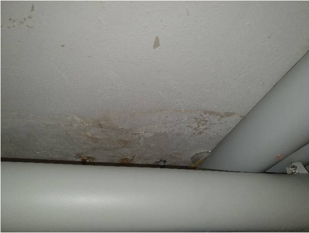
Vuotojälki kellarin katossa
