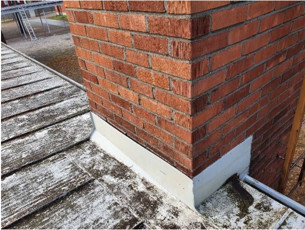
Öljykattilan piipun reunapellin yläreunat auki
