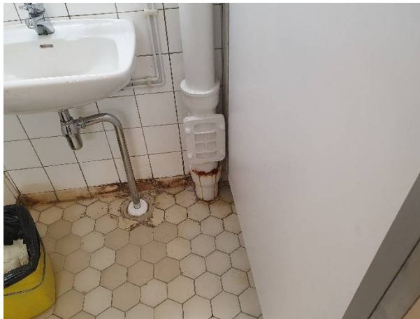
Viemärin tuuletusputken tarkastusluukusta vuotaa vettä
