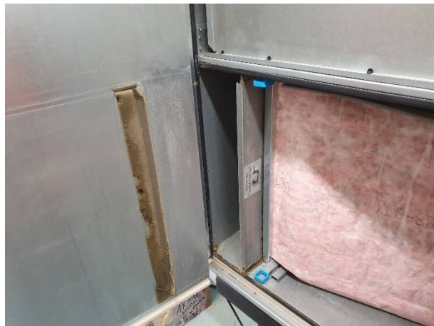
Koneen luukun tiivisteet huonokuntoiset
