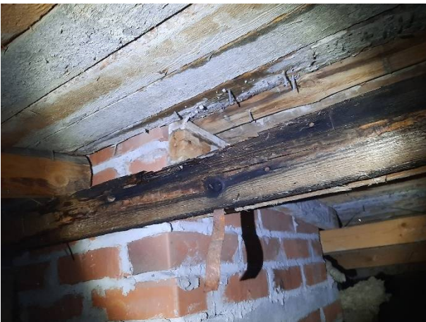
Tiilihormin nurkalla vuoto, kattopalkki laho
