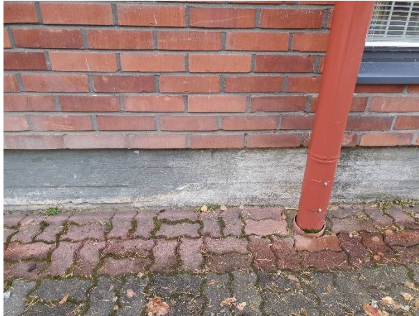
Sokkelin maalipinta hilseilee
