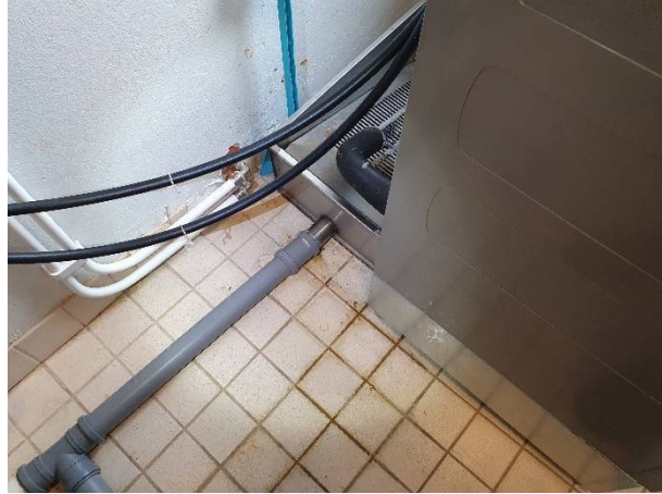
Kotitalousluokan pyykinpesukoneen takana olevan altaan viemäri vuotaa lattialle
