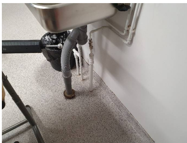
Käsityöluokkien rakennuksessa käyttövesiputket alkuperäiset
