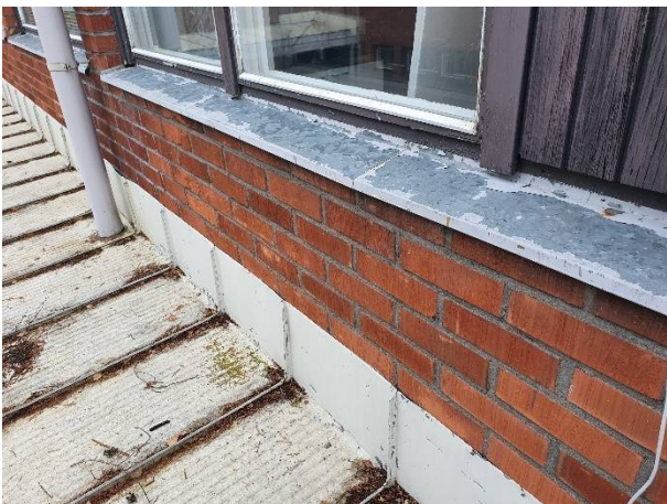
Ikkunoiden vesipelleistä maali irtoillut
