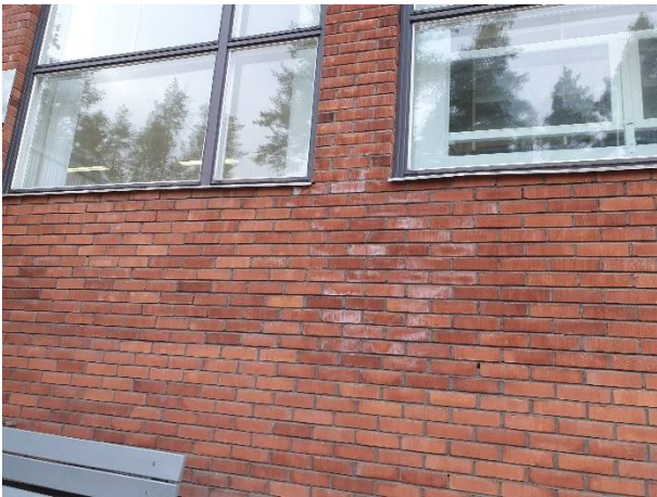
Kirjaston ikkunan alla kosteusjälki
