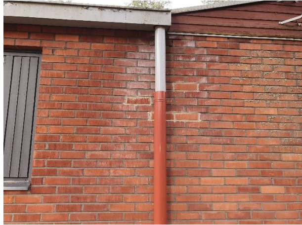
Syökytorven kohdalla seinässä kosteusjälki
