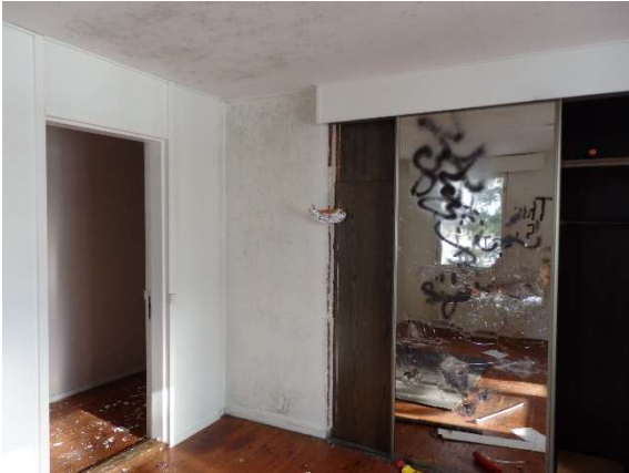
2. kerroksen sisäseinien maalipinnat.
