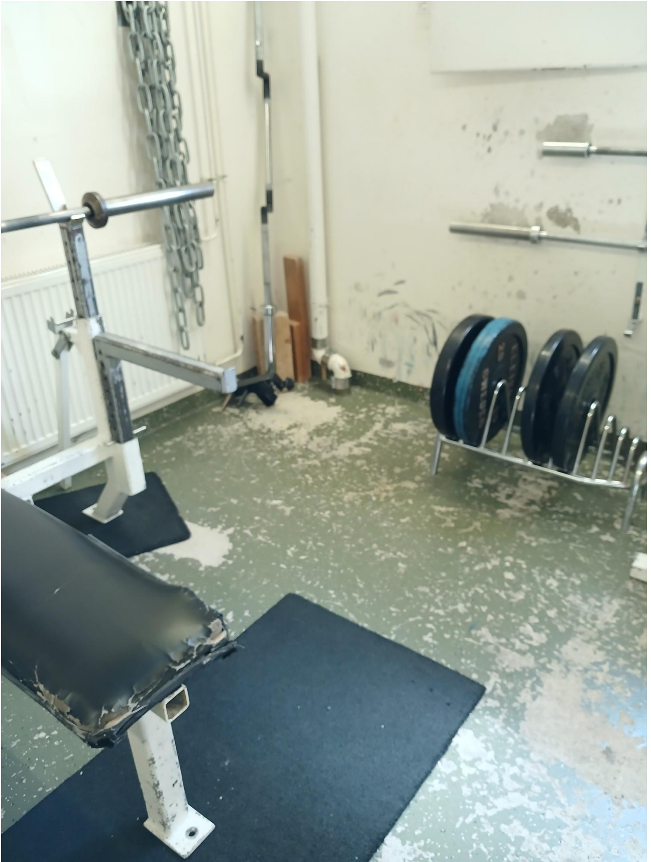
Kuva 2. Voimanosto puolen lattian kunto
