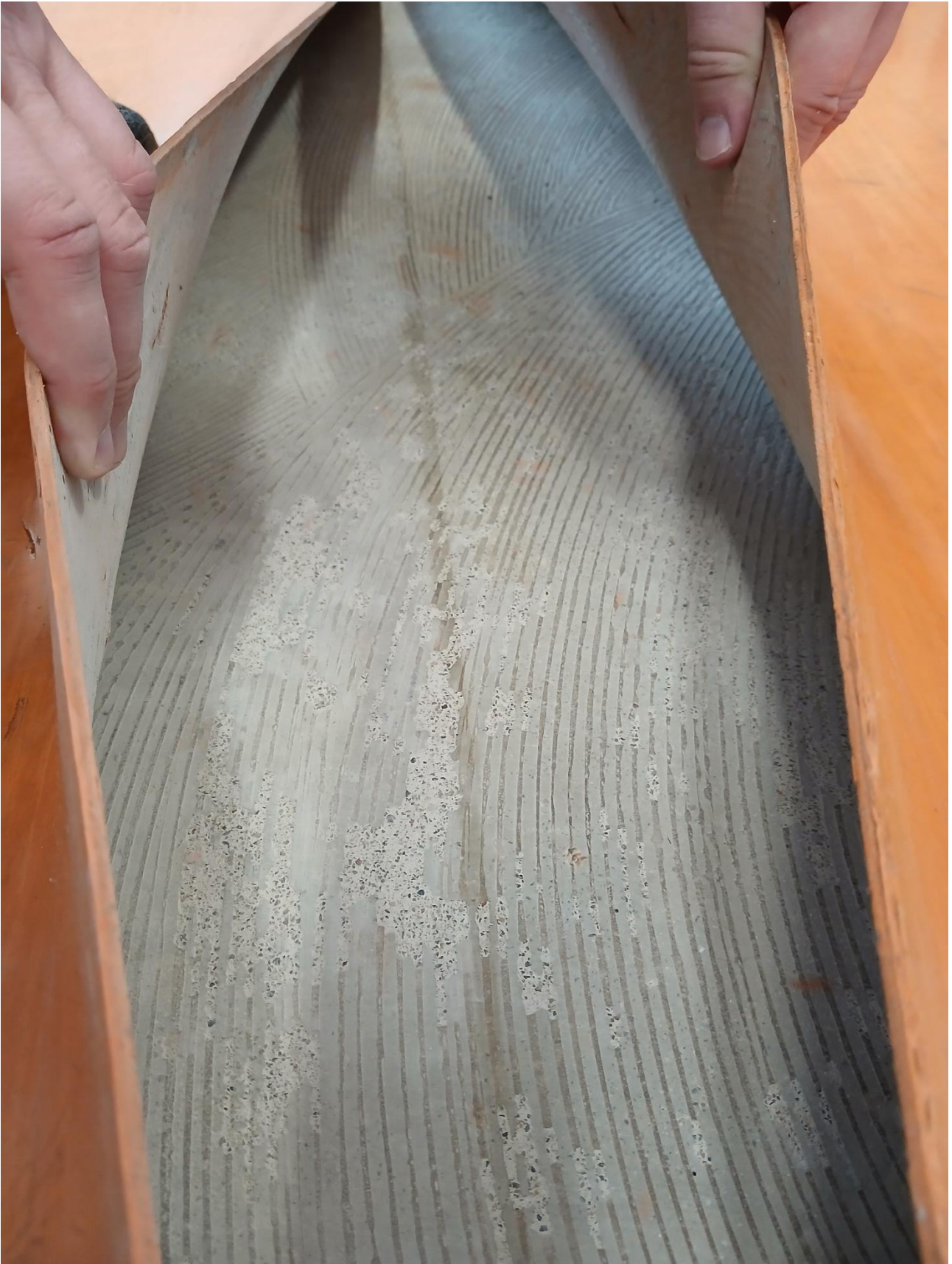
Kuva 1. Nyk. betonilattian kunto, kuntosalin puolella
